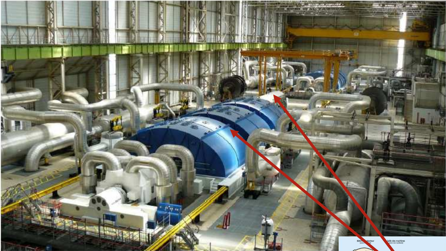
Salle des machines réacteurs 1 et 2 : turbine et alternateur
