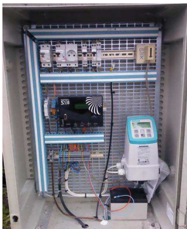
Figure 28 : poste local de télétransmission, SIAEP du Blayais
