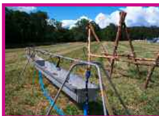
Point d'eau avec système de collecte des eaux usées
