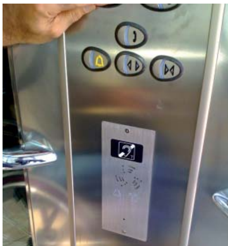
BIM dans un ascenseur
